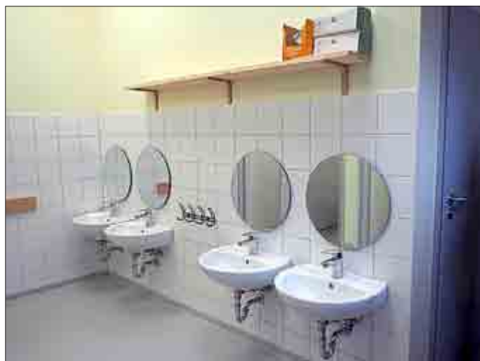
Neu geschaffenen sanitären Anlagen
